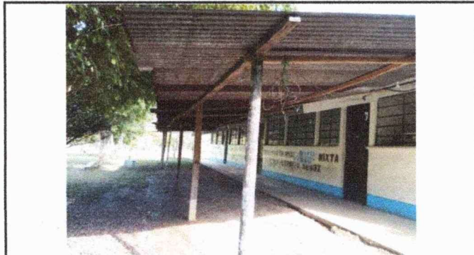
Foto 3: Se observa que el sistema eléctrico no es el adecuado y carece de iluminación en la extensión del corredor.
