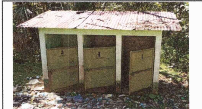
Foto 4: se observa el modulo de los baños deterioro en el techo y las paredes expuestas a la humedad y a los elementos de la naturaleza.
