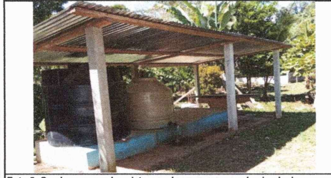
Foto 5: Se observa que los cisternas de agua carecen de circulación, o algún tipo de pared.
