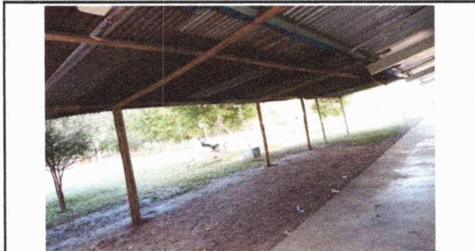
Foto 2: se observa que el piso de la extension del corredor no tiene piso adecuado y falta la colocación de barrandales.
