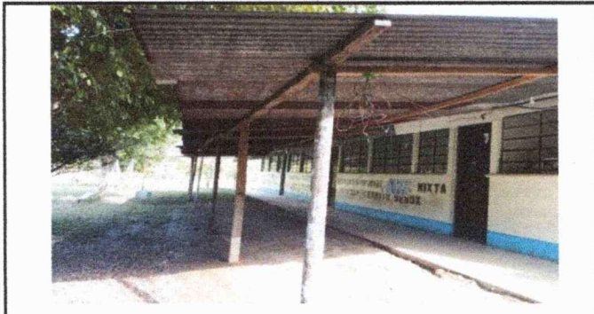
Foto 1: se observa el deterioro del techo de la extension del corredor y su estructura.
